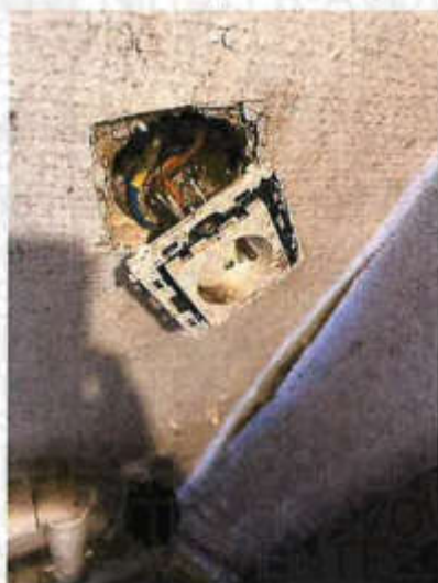
B.7.3 a) : L'enveloppe d'au moins un matériel est manquante ou détériorée.
