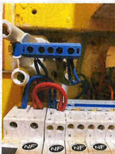
B.4.3 f) : A l'intérieur du tableau, la section d'au moins un conducteur alimentant les dispositifs de protection n'est pas adaptée au courant de réglage du disjoncteur de branchement.
