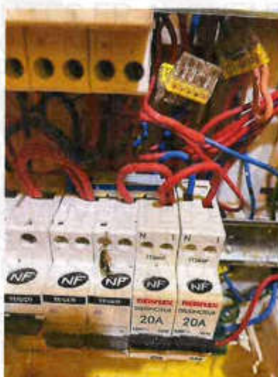
B.4.3 g) : A l'intérieur du tableau, la section d'au moins un conducteur alimentant les dispositifs de protection n'est pas adaptée au courant de réglage du disjoncteur de branchement.
